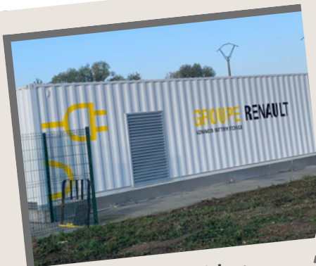
Batteriespeicher für Energie aus Windkraftwerken
